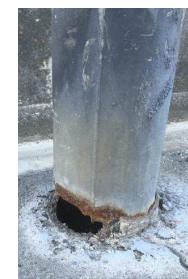
腐食した電柱
